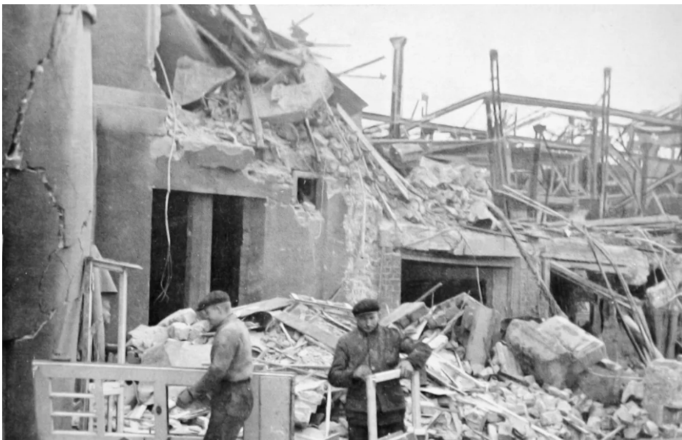
↑ Arbeiter von H & K in Dortmund sind mit der Enttrümmerung des Geländes an der Juchostraße beschäftigt.
